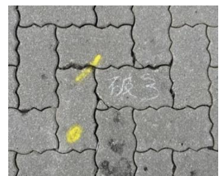
写真-3 ILブロック舗装の破損
