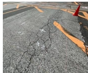
写真-2 半たわみ性舗装の破損
