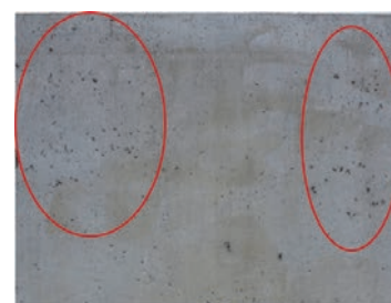
図-3 表面気泡の発生状況例(赤線内は気泡が多い部位)
