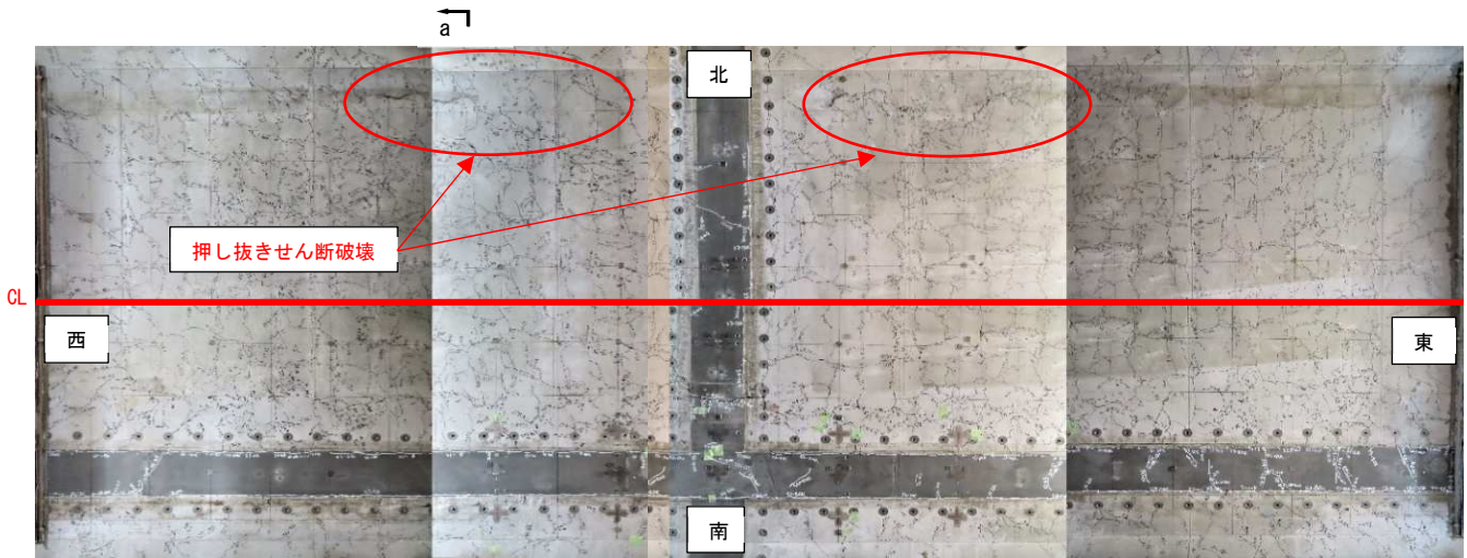
写真-1 床版下面ひび割れの様子 (破壊後)
