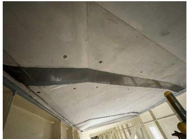
写真-3 UFC 複合床版および接合部の漏水確認
