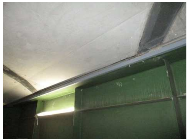
写真-4 後埋め部の漏水確認
