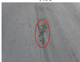
写真-4 表面の剥がれ
