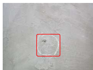
写真-3 一部に浮き(濁音)
