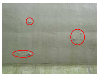
写真-2 膨れ及びはく離の状況
