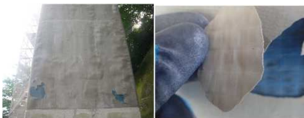
写真-1 モルタルの浮き・剥離状況
