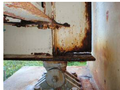
写真1 鋼橋桁端部の腐食状況
