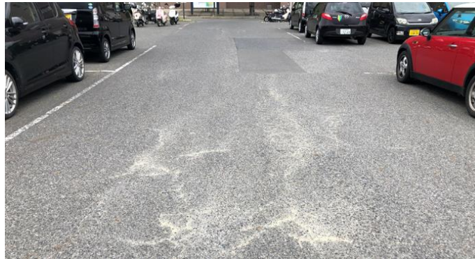
図-1 ポンピング発生状況
