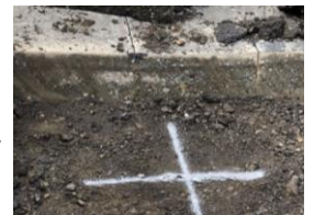
写真-1 路盤劣化
