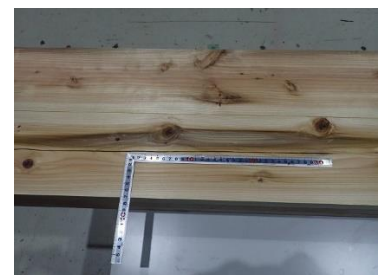
図-2 腐れの入った CLT 表層
