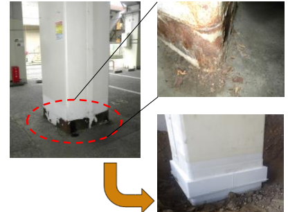
図-1 鋼板巻き補強柱の腐食部と対策工（再巻き立て）
