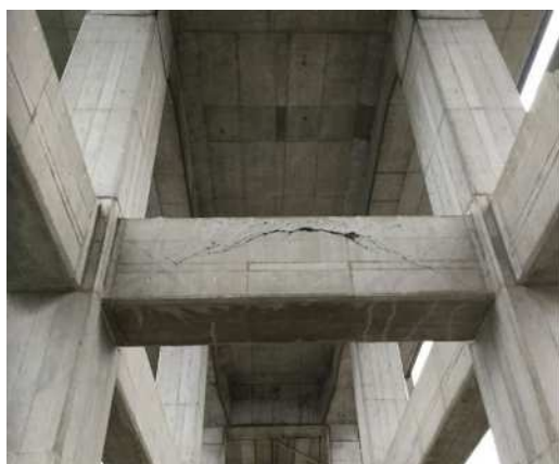
図-1 中層梁せん断破壊
