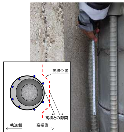
図-3 補強鉄筋の変形
