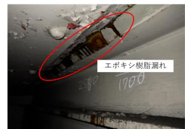
写真-1 2号目黒線におけるエポキシ樹脂の漏れ
