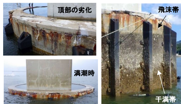
図-4 防衛壁の劣化状況
