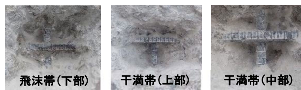
図-5 側面側の内部鉄筋腐食状況
