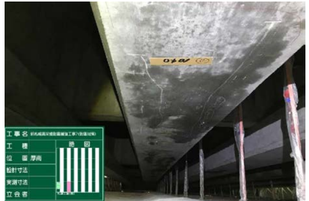
図1 主桁に生じた変状の例（漏水、ひび割れ）
