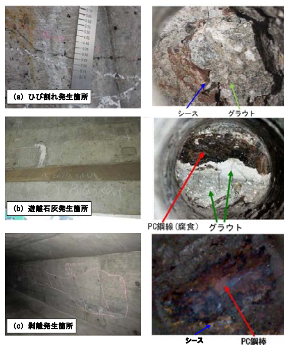
図-1 外観変状発生箇所のグラウト充填状況
