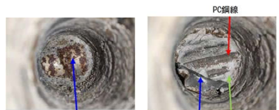
写真-1 PC 構成部材内部状況【シーすの腐食】
