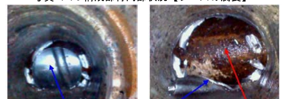
写真-2 PC 構成部材内部状況【PC 鋼材の腐食】
