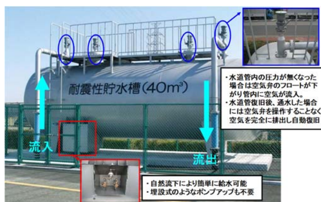
図1 地上式耐震性貯水槽
