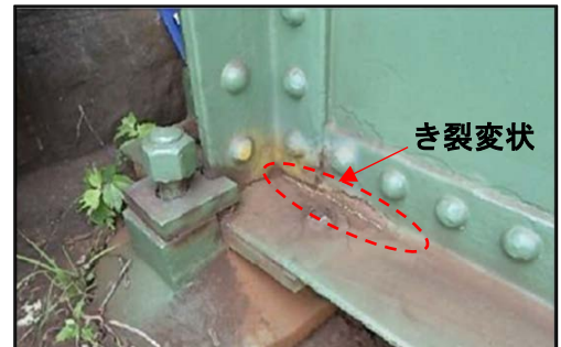
写真-1 支点部き裂発生状況
