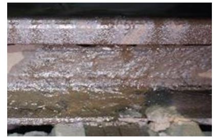
写真-4 未防錆レールの外観
