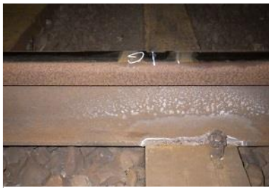
写真-2 白錆の発生状況
