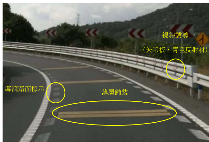
図-2 H23・H24 に実施した事故対策
