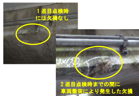
写真-3 新たな欠損発生を示す例
