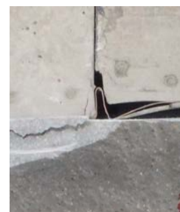
写真-3 最大鉛直力載荷時の銅製止水版の状況
