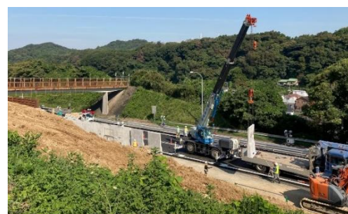
写真7 置式防護柵の設置状況
