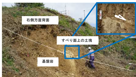
写真-4 右側方崖背面のすべり面
