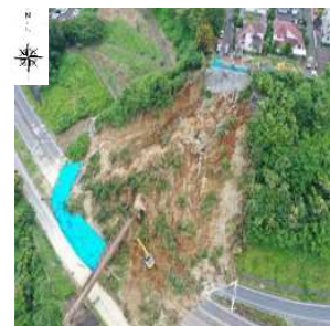
写真-1 崩落状況
