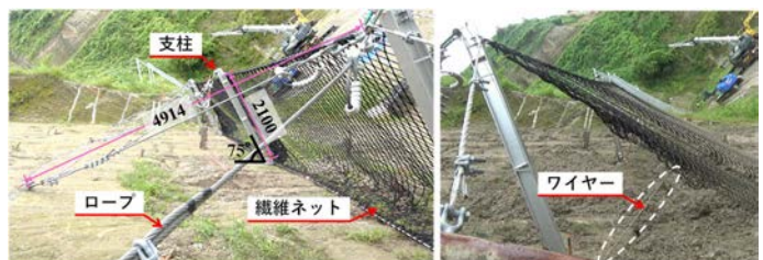
(a) 防護柵を見下ろした図 (b) 側面からみた図
