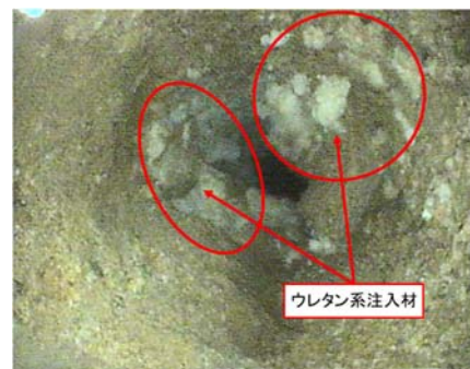
写真-2 空洞位置での画像調査
