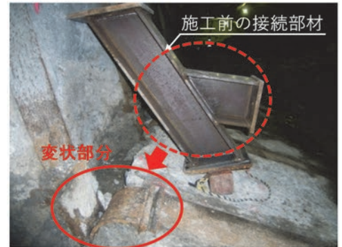
写真-1 下半支保工脚部での変状
