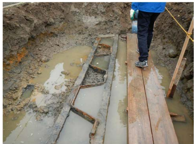
写真4 浜戸川④における堤内側の矢板の頭部
