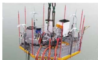
Photo 4 ステージ上設備
