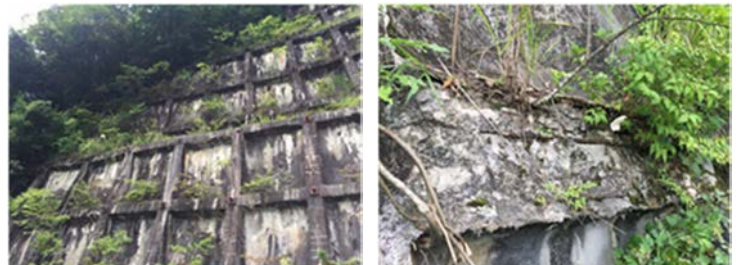
写真1 吹付のり枠劣化状況 左：遠景 右：近景
