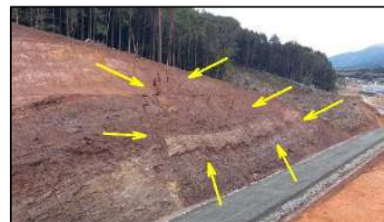
図-1 法面のクラック発生状況
