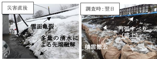
写真1 鉄道盛土にける融雪災害事例 (事例1)
