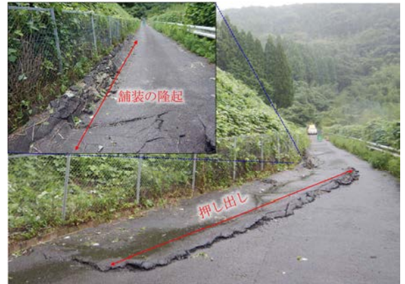
図-1 変状の進行 (令和3年8月16日)
