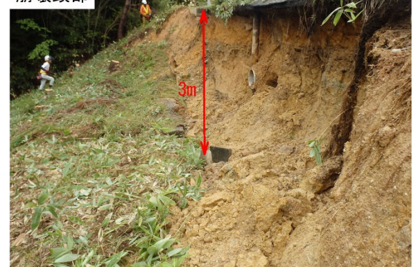
図-1 盛土のり面被災状況
