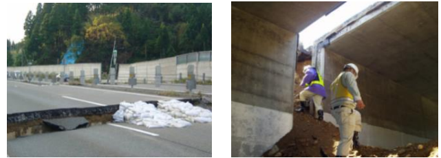
写真1 2004年新潟県中越地震による高速道路の被害 2)
