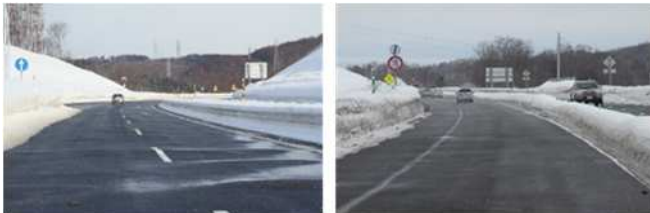
写真-1 路面不陸状況 (左：下り線, 右：上り線)
