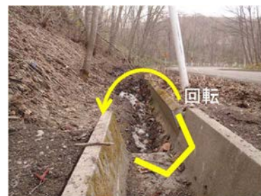
写真-1 のり尻排水溝変状例
