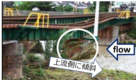
図-1 H29年男里川橋梁の被災の様子 1)
