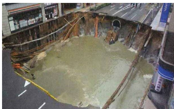
図-4 JR博多駅前で発生した道路陥没 (2016年11月8日)
