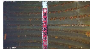
図-4 内壁部付着物状況
