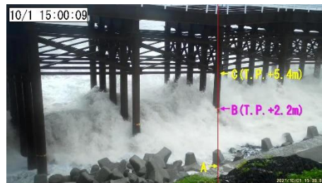
図-5 波のうちあげ状況(インターバルビデオ)
