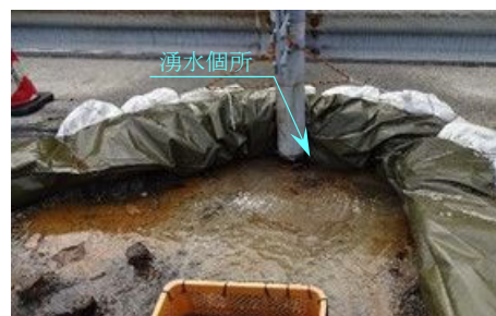
図-2 中央分離帯部湧水状況
