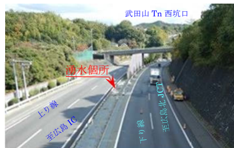
図-1 湧水浸出し状況
