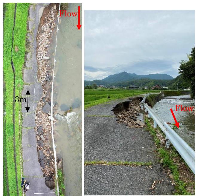
写真-1 2.6k地点での被害箇所②
