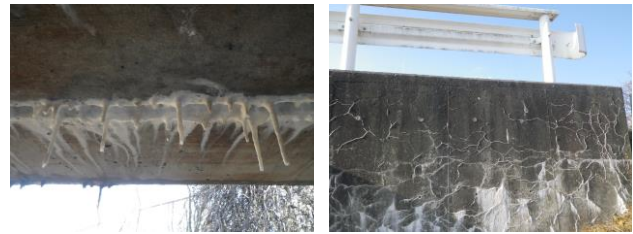
図-3 ワッカナイ小橋桁下および橋台の遊離石灰
