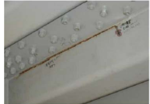
写真-1 縦溶接部のビード貫通き裂
