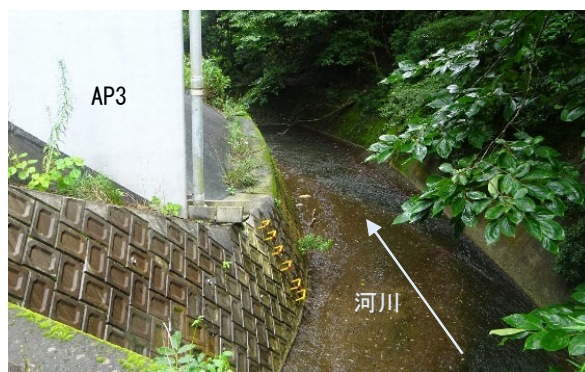
写真-2 交差状況（AP3橋脚付近）
