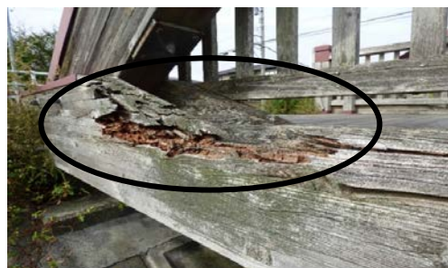
写真-1 下弦材の断面変化部の腐朽
