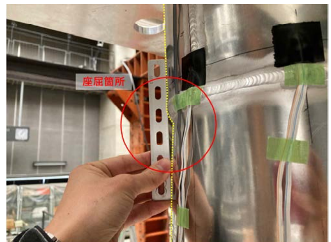
写真-3 #5 試験体座屈状況(近景)
