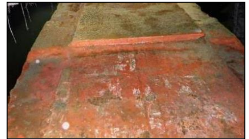
写真③ カバープレート撤去後の上フランジの状態
