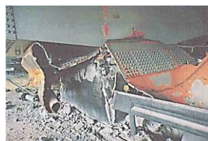
(a) 角溶接部が割れて崩壊した鋼製橋脚 1)
