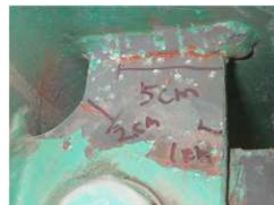
写真1 疲労き裂発生状況
